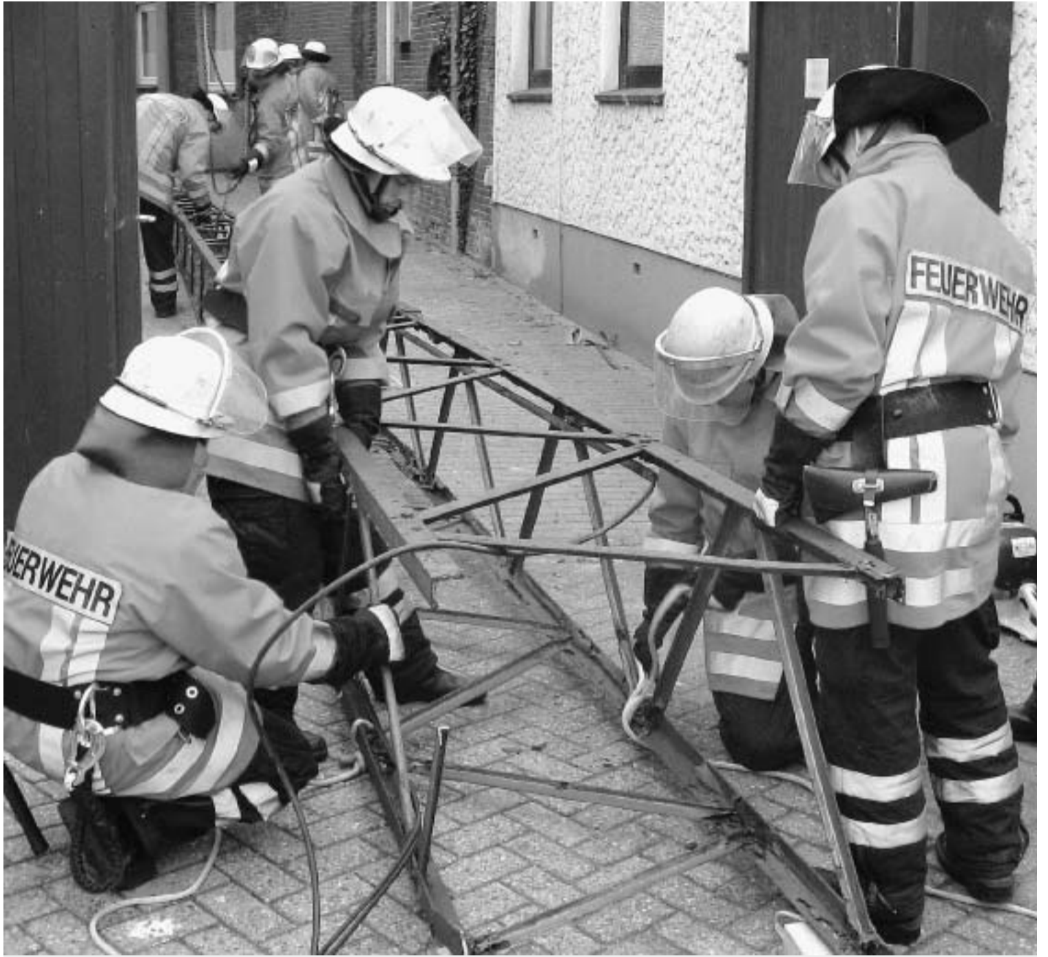
Insgesamt vierzig Einsatzkräfte sowie ein zusätzlich angemieteter Autokran waren von Nöten, um den über 700 Kilogramm schweren, ehemaligen Funkmast hinter dem Berner Rathaus seines angestammten Fundaments zu entheben. CP-FOTOS: PFEIFF
