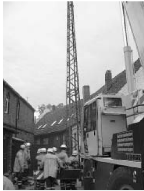
Noch steht der Mast an seinem angestammten Platz.
