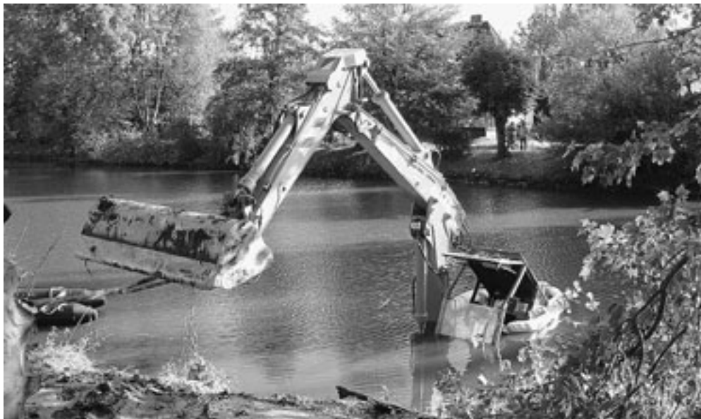
Bei Arbeiten an einer neuen Verrohrung zur Entwässerung in Ganspe rutschte dieser Bagger in den Motzener Kanal.
