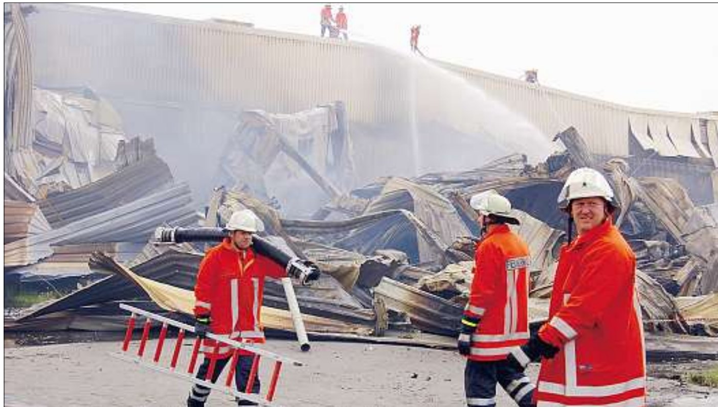
Aufräumen nach dem großen Brand: Nach gut sechs Stunden war das Feuer in der Fertigprodukte-Lagerhalle gelöscht, die Feuerwehrleute begannen nach dem erfolgreichen Einsatz ihre Sachen zu packen. BILDER: WOLFGANG BEDNARZ
